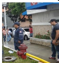
Hidrante carrera 32 con calle 31
