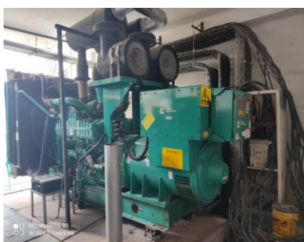
PLANTA ELÉCTRICA N°. 1
