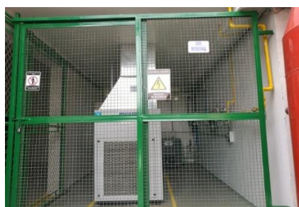
Equipo Atlas copco ref. AQ 30 VSD
