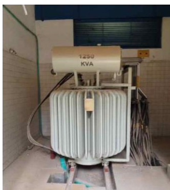
Transformador de 1.250KVA
