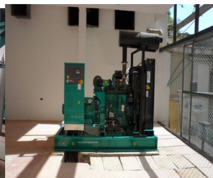
PLANTA ELÉCTRICA N°. 3
