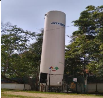
Tanque de oxígeno
