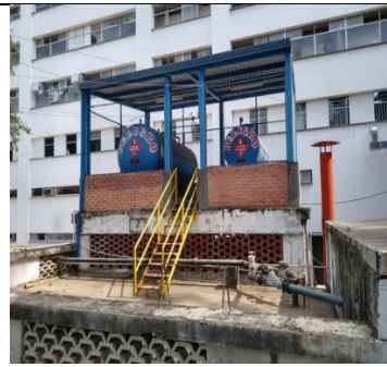
Tanque de ACPM
