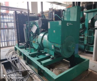
PLANTA ELÉCTRICA N°. 2
