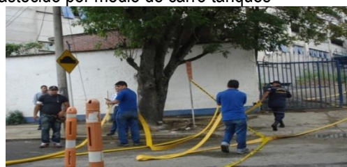
Conexión por medio de mangueras desde el hidrante hasta el tanque de reserva
