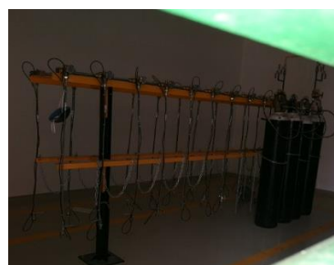
Manifold de 26 puestos
